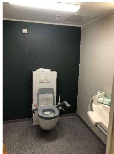
Dette vendbare toalettet er nylig installert.
